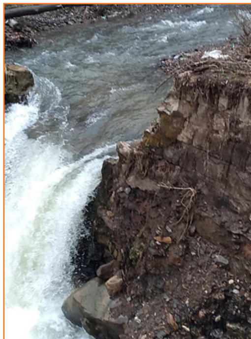
Uništena protiverozina ustava
